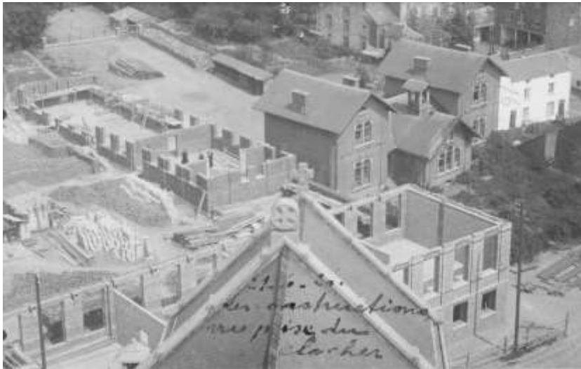
La construction de la nouvelle école des Frères, avec à l'arrière-plan à droite le bâtiment initial
