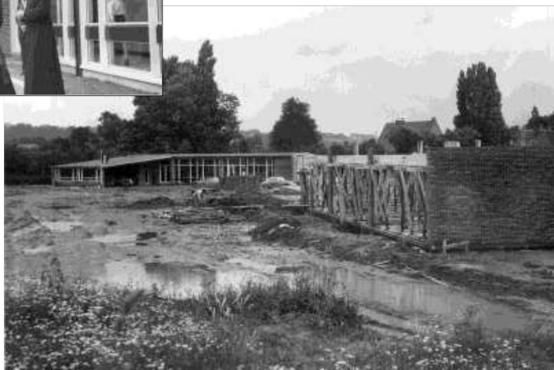
Une vue du premier bâtiment du collège prise lors du début des travaux de la construction du deuxième bloc ⇨
